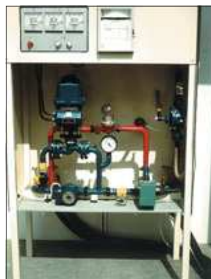
▲ Obr. 18 ● Pohonná solární jednotka s „malým a velkým okruhem“
