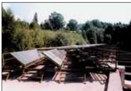
▲ Obr. 8 ● Konstrukce nad střešním pláštěm včetně eventuálních pochozích chodníků z porořstu, přenáší zatížení do obvodových zdí
