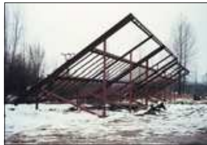
▼ Obr. 12 ● Další speciální solární střecha, pod kterou je úpravna a ohřev vody pro venkovní bazén, kolektory již tvořily střechu v rovině
